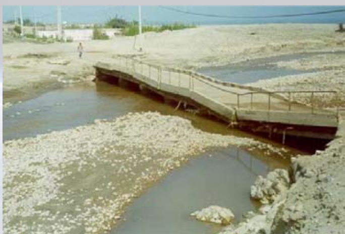
Zničený most neďaleko pobrežia v Peru – dôsledok silných dažďov zapríčinených El Niňom
