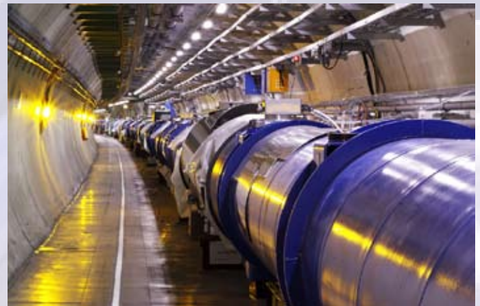
Magnety uložené v tuneli (foto: CERN)
