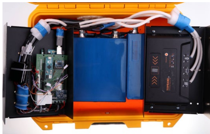
Detail riadiacej jednotky s batériami
